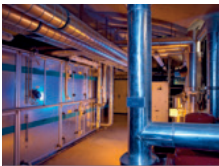
Lüftungszentrale im Bürohaus Hegelgasse (Strauß & Partner) im Auftrag des GU Porr AG
